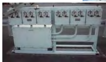
第1バース リーファーコンセント 192口（整備済み） 第2バース リーファーコンセント 96口（H30整備完了）
